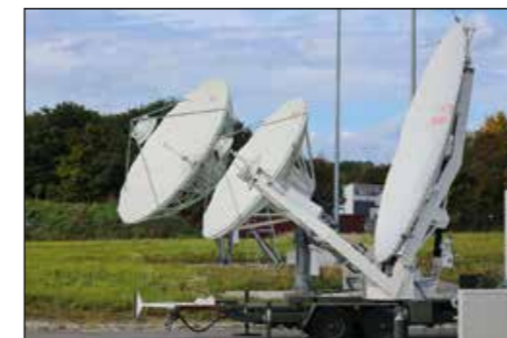
Abb. 4: Antennen des Munich Center for Space Communications der Universität der Bundeswehr München (Quelle: Thomas Benz, just imagine)
