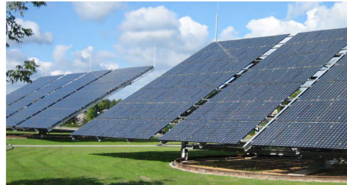
Photovoltaik-Anlage in der Von-Zieten-Kaserne in Beelitz
