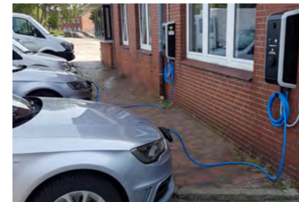
Elektrofahrzeuge an Ladestationen in einer Bundeswehrekaserne
