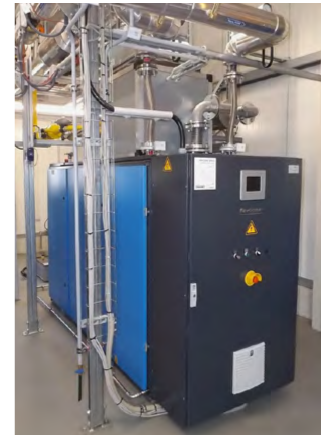
Blockheizkraftwerk in der Ferdinand-von-Schill-Kaserne in Torgelow
