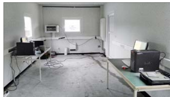
Abb. 2: Netzwerkinstallation als Testobjekt im EM-Raummodul
